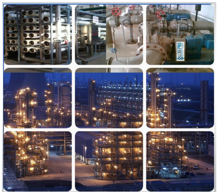
扬子石化净水车间 中水回用一期二期工程 MBR 车间 采用 6 台 270 方/小时罗博思达转子泵
