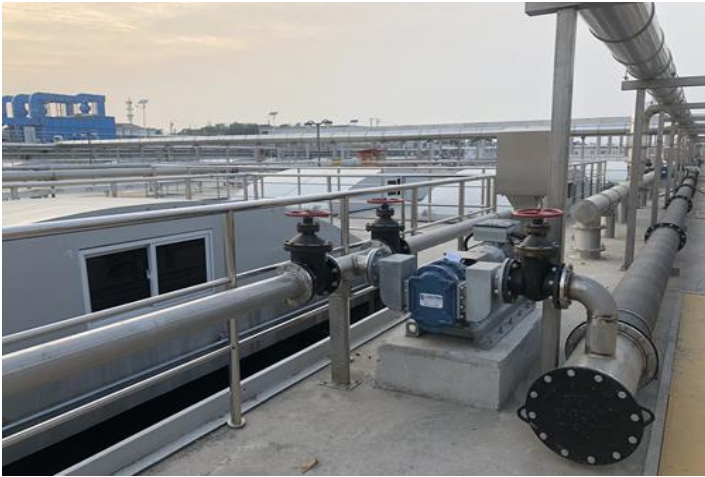
上海白龙港污水厂 280 万吨/天 40 台 20-30 方/小时转子泵，自吸 5-6 米排渣（砂） 运行时间 2018 年 12 月 运行 2 年无维修记录
