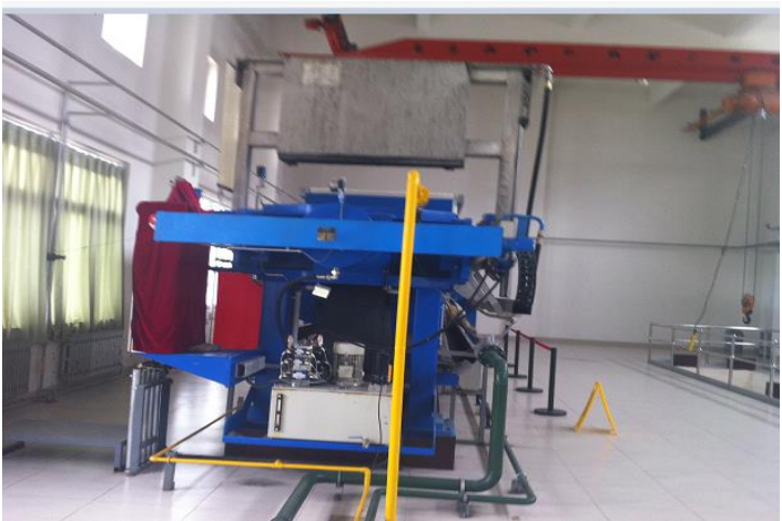
板框压滤机进料泵 湖北大冶污水厂，2 台 50-100m 3 /h 板框机进料泵 要求自吸 3-5 米，出口压力 10-12bar,运行 2 年才更换备件；
