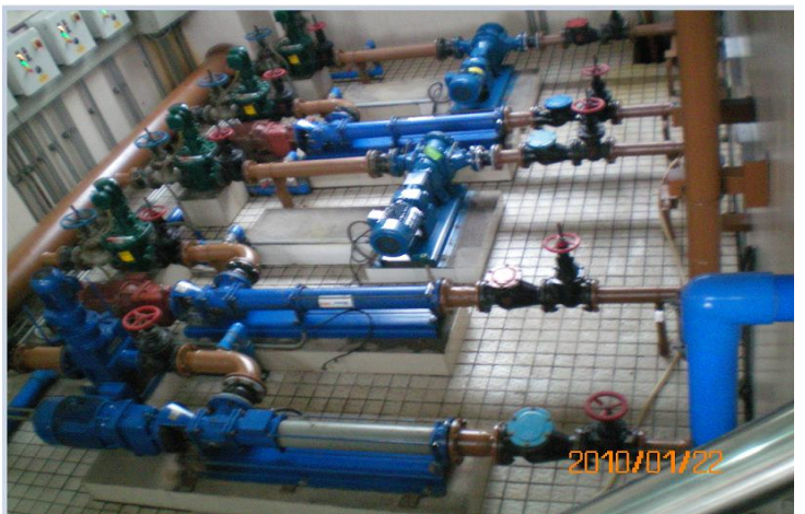
离心脱水进料泵 重庆鸡冠石污水厂，2 台 30-50m 3 /h 离心机进料泵 污泥含砂率高，替代后降低维护成本 50%以上
